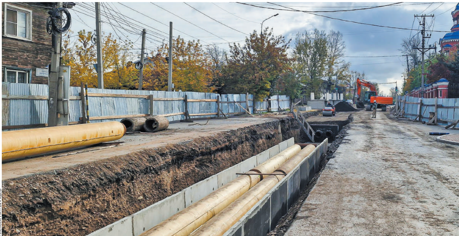
Основная часть теплотрассы проходит по улице Баррикад.
