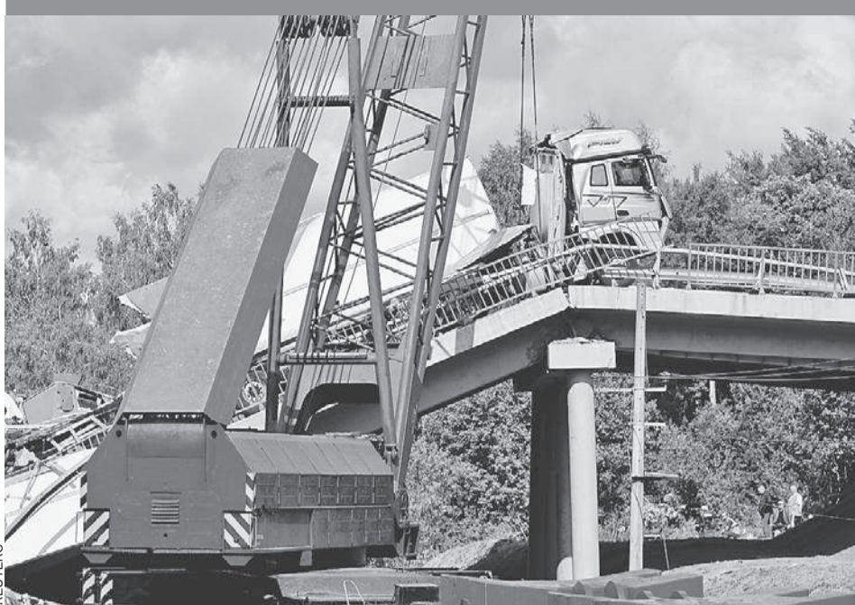
Грузовик с железнодорожных путей убирали специальным краном. Водитель большегруза выжил, помощь ему оказывают врачи.
